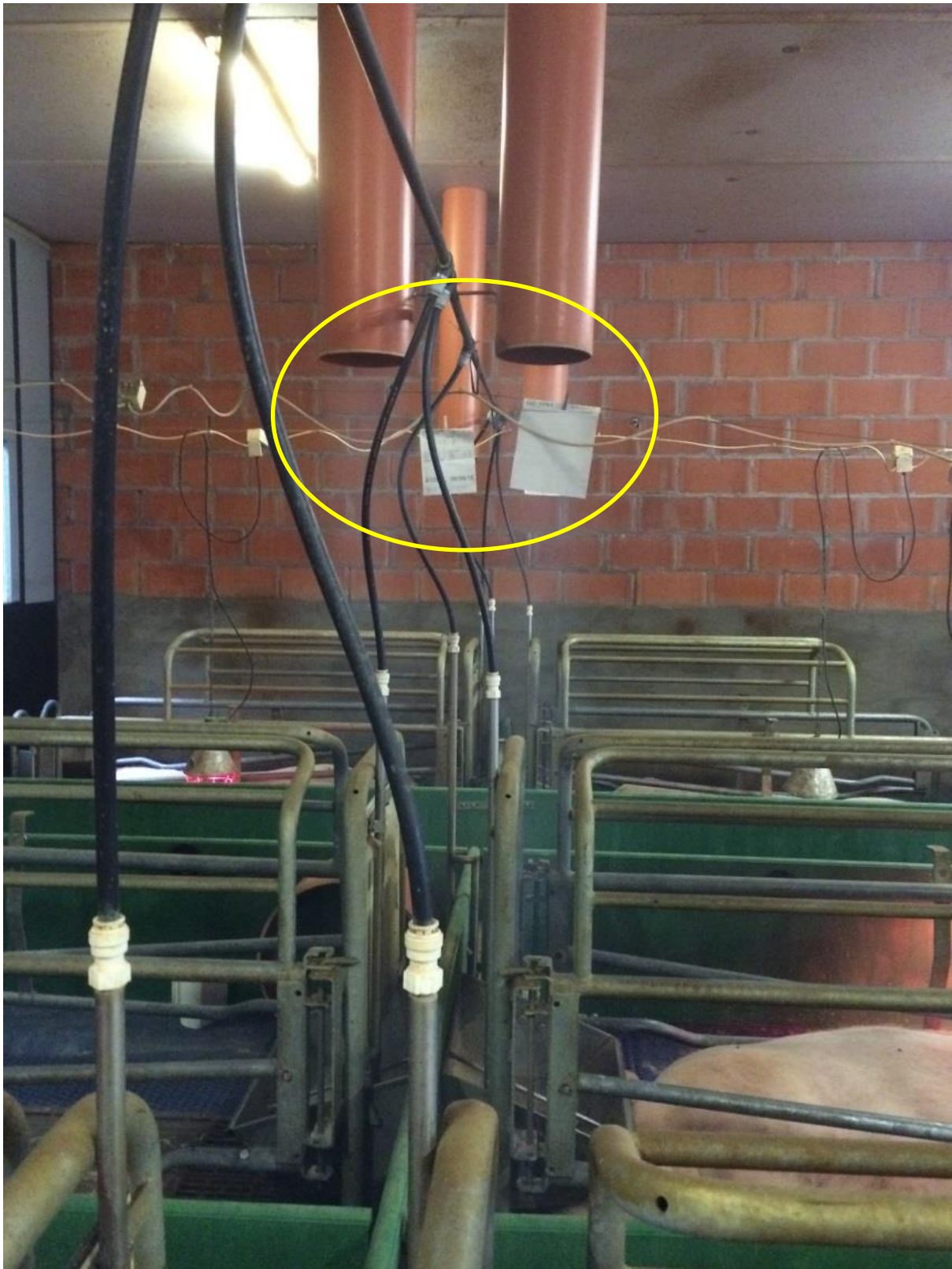
15. melléklet: A kocák felé helyezett légbeejtőkön keresztül érkezik a „füsttel jelzett” friss levegő az épületekbe
